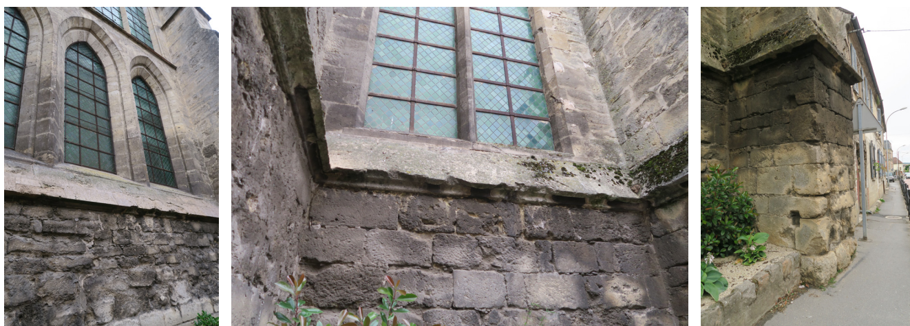
À gauche, croûte noire formée sous le larmier et encrassement au niveau des meneaux des baies du transept sud. Au centre, croûte noire formée sous le larmier de la baie sud de la chapelle du sépulcre, favorisant les phénomènes de pulvérulence. À droite, croûte noire formée sous le larmier du contrefort est du transept sud, la partie inférieure est probablement nettoyée régulièrement par les eaux de rejaillissement (juin 2020, photographies ACV Architecte).
