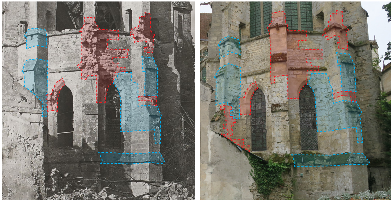
En bleu : éléments dégradés et non restaurés. En rouge : zones effondrées, remontées lors de la restauration de 1920-1929. À gauche, photographie des dégâts causés par la Première Guerre mondiale au niveau du chevet (BnF, cote VE-374 (7)-4). À droite, vue actuelle du chevet (juin 2020, photographie ACV Architecte).
