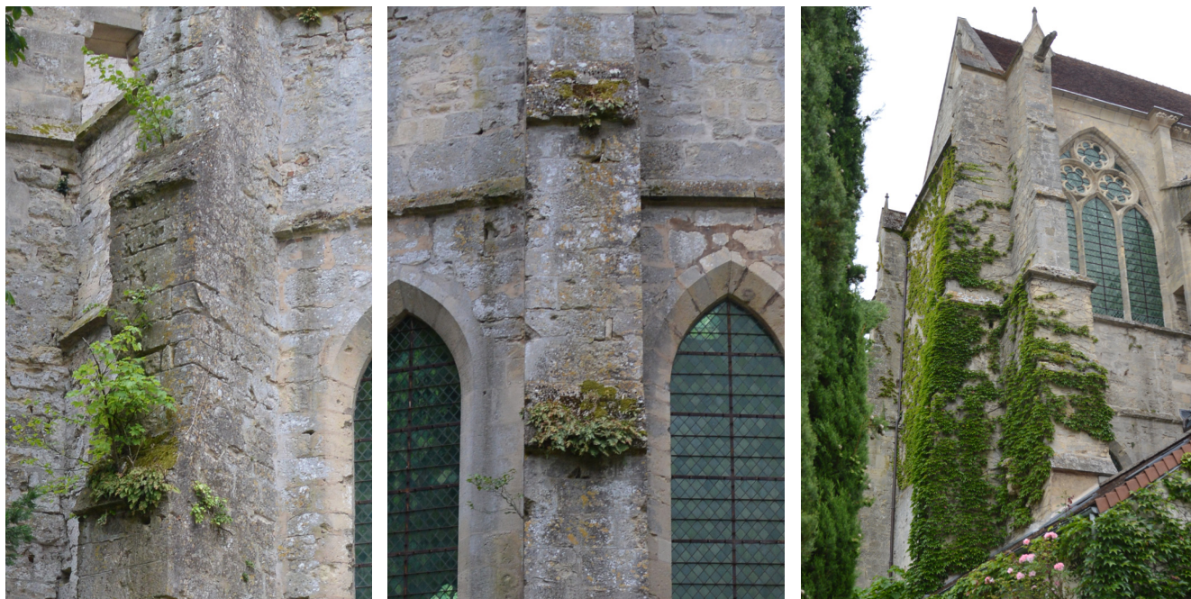
À gauche et au centre, casses et lacunes, colonisations biologiques et déjoints au niveau de deux contreforts nord du chevet. À droite, développement de lierre sur les contreforts nord-ouest du transept nord (juin 2020, photographies ACV Architecte).
