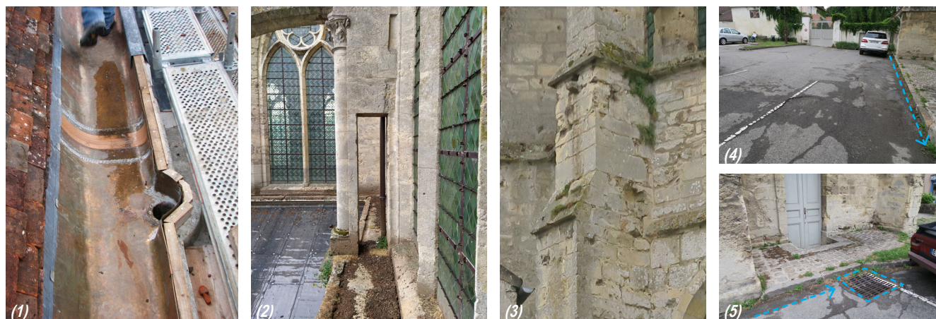
(1) chéneau encaissé et départ de descente d'eaux pluviales dans la corniche de couronnement côté ouest du transept sud après la restauration de T. Algrin (ACMH) (2012, photographies T. Algrin, ACMH). (2) vue du caniveau de la coursive extérieure obstrué par des amas de fientes d'oiseaux. (3) ruissellement des eaux de pluies évacuées par un petit exutoire sur le parement d'un contrefort du chevet. (4) et (5) évacuation en aérien des eaux pluviales au pied de la façade ouest (juin 2020, photographies ACV Architecte).
