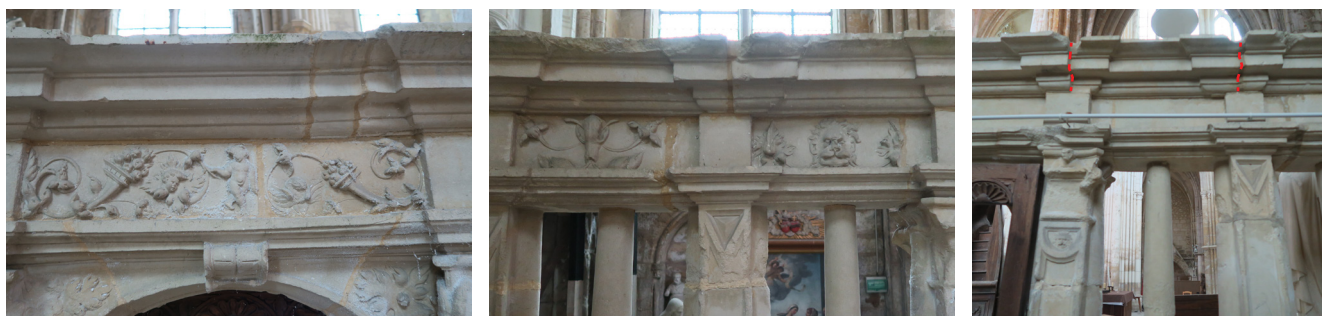
À gauche, frise ornée au niveau du linteau extérieur de l'ouverture de la clôture nord. Au centre, détail de l'ornementation de la frise extérieure de l'entablement de la clôture nord. À droite, détail de retraits inexplicables, localisés en pointillés rouges, visibles au niveau de la frise intérieure de l'entablement de la clôture nord (juin 2020, photographies ACV Architecte).
