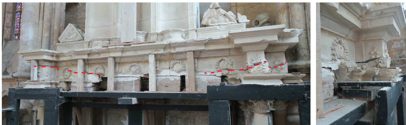
À gauche, entablement du retable, les fissures de traction sont représentées en pointillés rouges. À droite, détail de la partie droite de l'entablement (juin 2020, photographies ACV Architecte).
