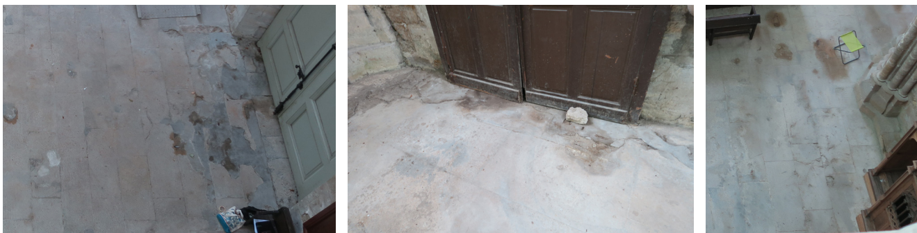
À gauche, reprises du sol au ciment, dalles fissurées voire fracturées au niveau du pas intérieur de la porte principale de l'élévation ouest. Au centre, reprises du sol au ciment, dalles très dégradées au niveau du pas intérieur de la porte sud de l'élévation ouest. À droite, dalles fissurées dans l'angle nord-est du transept nord (juin 2020, photographies ACV Architecte).
