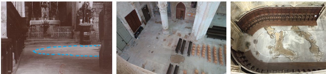
À gauche, trace d'efflorescences salines visible (pointillés bleus) au niveau du transept sud en 1911 (BnF, cote VE-377 (8)-4) ; Au centre, traces d'humidité et d'efflorescences salines visibles au niveau du sol de la nef. À droite, traces d'humidité et d'efflorescences salines visibles au niveau du sol du chœur (juin 2020, photographies ACV Architecte).
