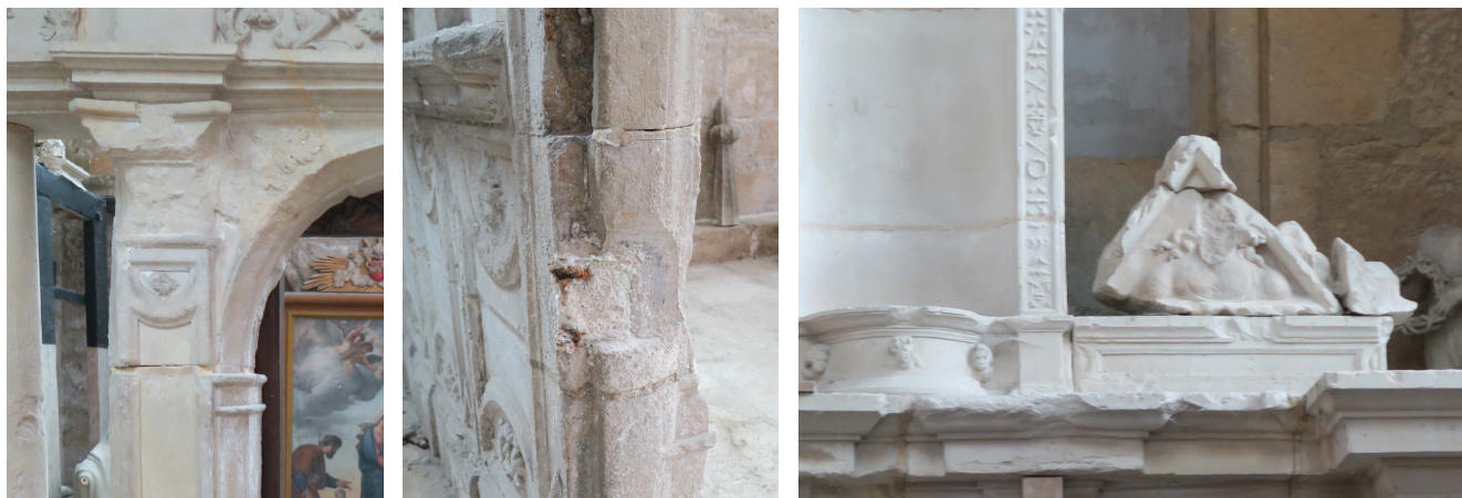
À gauche, détail de la clôture nord, décor lacunaire au niveau de l'encadrement de la porte. Au centre, détail de la clôture ouest, éclatement de la maçonnerie au niveau du gond. À droite, détail de décor sculpté lacunaire à droite de l'entablement du retable (juin 2020, photographies ACV Architecte).
