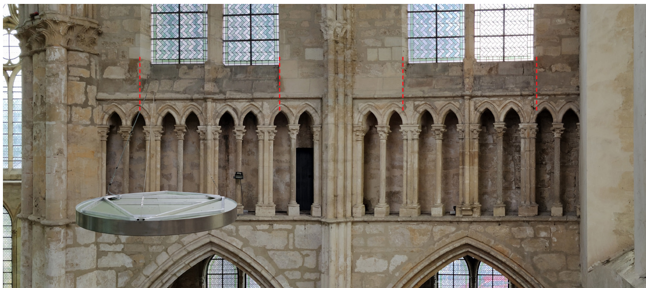
Absence de concordance entre les baies hautes de la nef et la galerie de triforium (juin 2020, photographies ACV Architecte).
