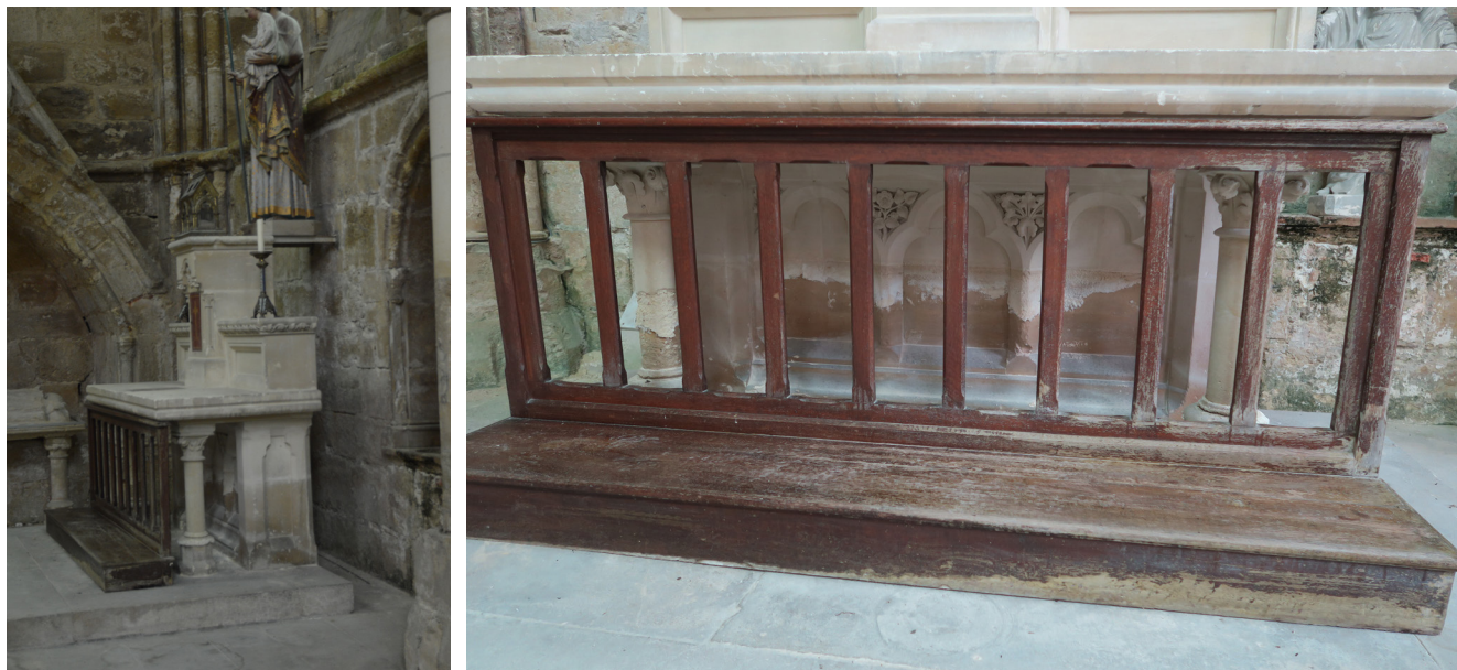
Vues de côté et de face de l'autel de la chapelle nord du transept nord, d'importantes traces d'efflorescence sont visibles (juin 2020, photographies ACV Architecte).
