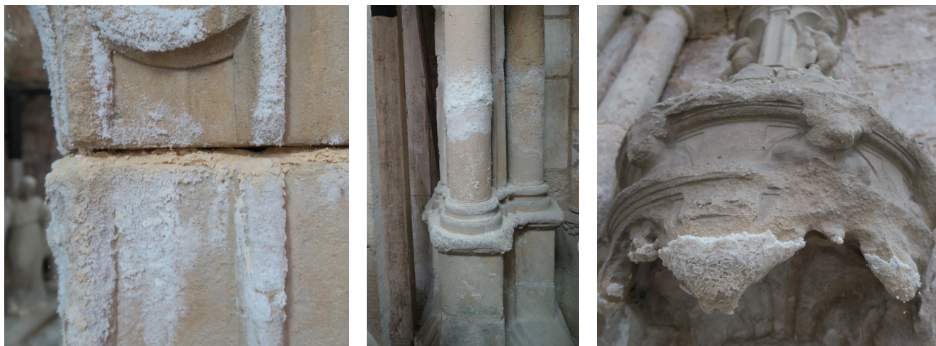
À gauche, efflorescences pulvérulentes au niveau d'un joint de l'ébrasement de la porte de la clôture nord. Au centre, efflorescences pulvérulentes en forte épaisseur au niveau des colonnes supportant l'extrémité droite de l'entablement du retable. À droite, efflorescences en film mince et décor sculpté lacunaire au niveau du dais du bénitier (juin 2020, photographies ACV Architecte).
