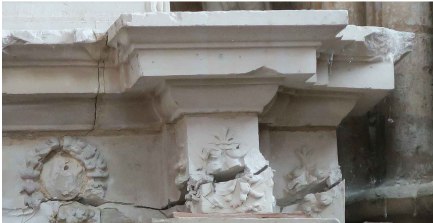
b. frise sculptée fissurée transversalement
