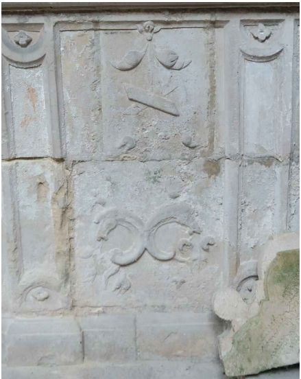
d. partie inférieure de la clôture : les ornements sculptés du panneau sont fortement dégradés et peu lisibles
